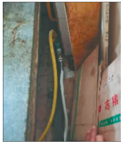
某饭店穿墙私接居民燃气管线。
