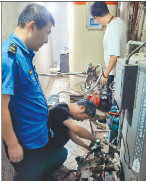
某浴后私接燃气管线,未经任何法定燃气计量装置连接锅炉。
