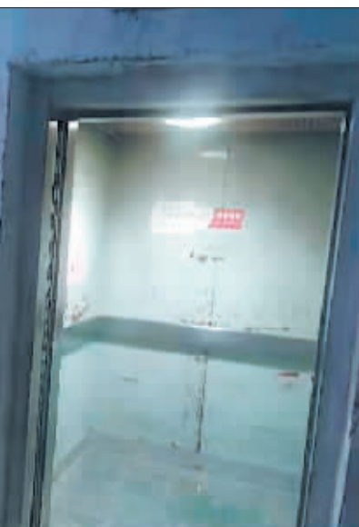
电梯“带病运行”,经常困人。
