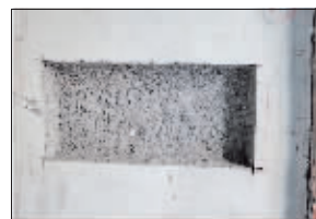
承重墙被破坏。
