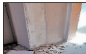
部分墙皮基层未按合同处理。
