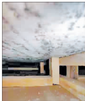
顶棚被楼上渗水浸泡。
