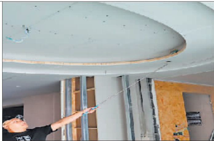
吊顶约定为双层石膏板,实际为单层。
