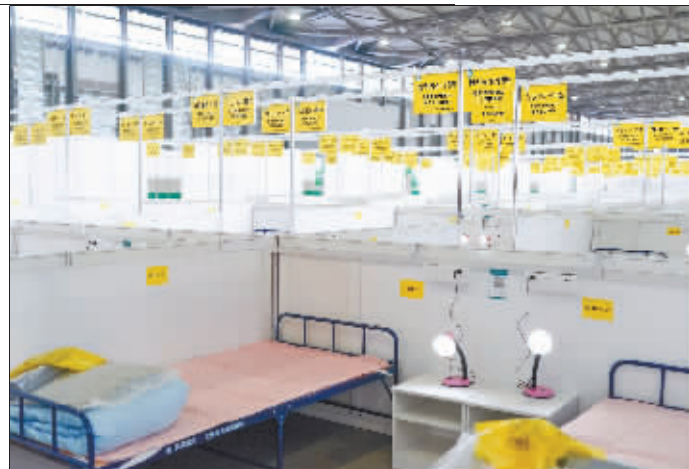
位于上海浦东新区的新国际博览中心正紧张施工,将成为上海又一家收治轻症和无症状感染者集中隔离点,设计床位超过15000张。
