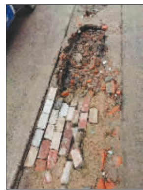
小区塌陷的地面。
