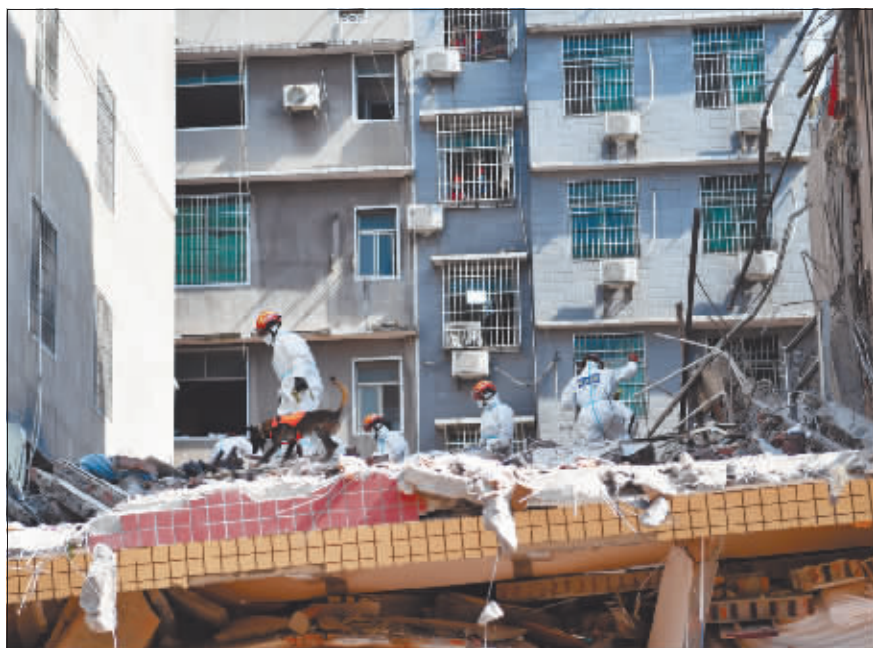
6日,长沙居民自建房倒塌事故现场搜救工作结束。
