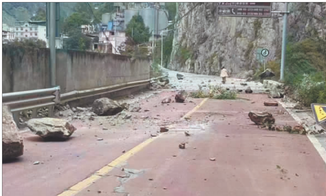
山石掉落在四川省甘孜州泸定县冷碛镇附近的道路上(9月5日摄)。
