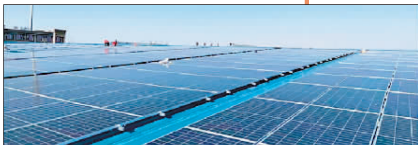
地面光伏项目。
