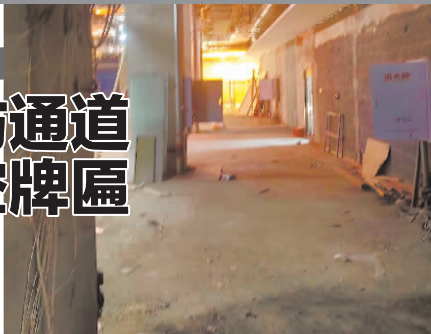
被占用的消防通道。
