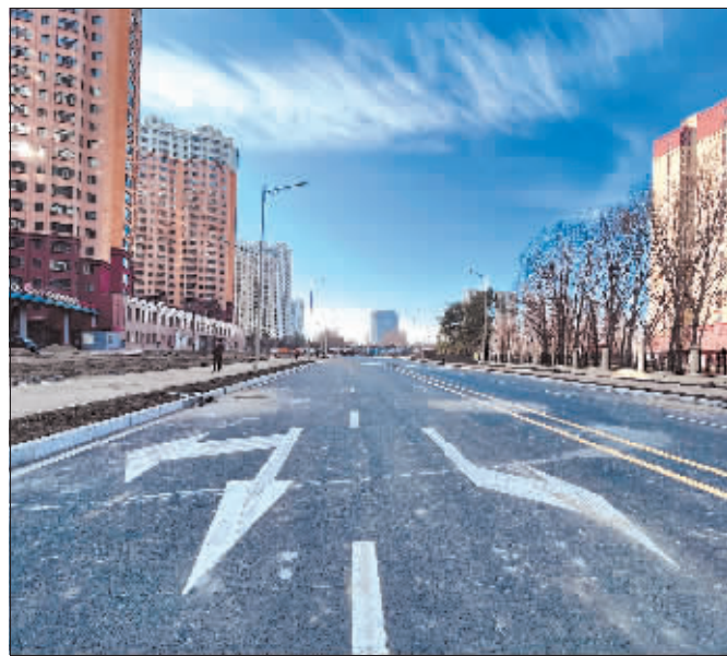
8日,道里区康泰家园周边道路工程施工现场,路面已经铺设完毕,施工人员正在进行绿化带等道路附属设施的建设。据了解,康泰家园周边道路工程包括青海路、南北路两条道路工程,其中青海路西起南北路,东至融江路;南北路北起滇池路,南至青海路。两条道路通车后,将进一步完善周边路网功能,为居民出行带来便利。
