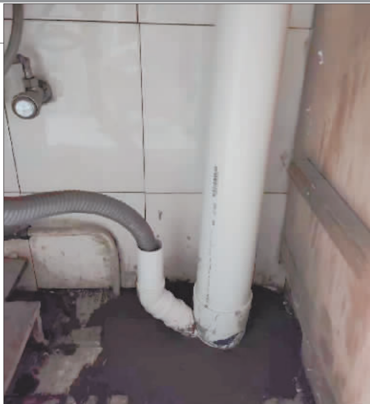
永和街43号2单元居民家下水终于能正常用了。图片由居民提供
