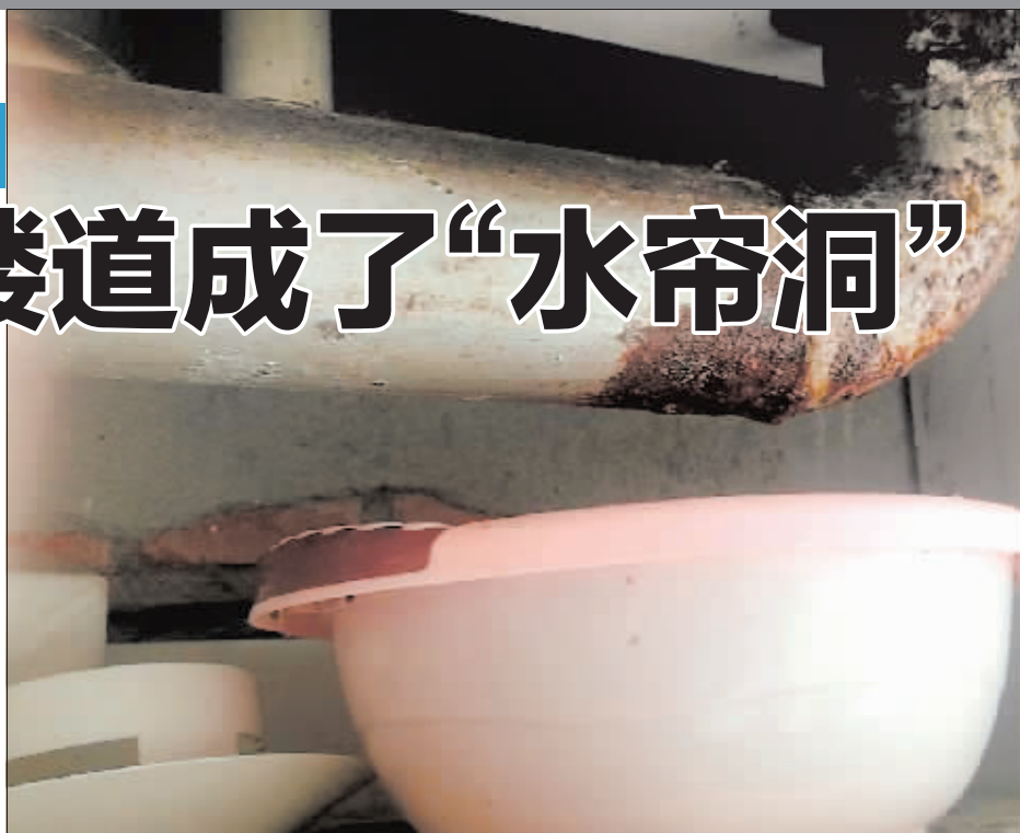
居民在家中吊柜上放置水盆,接着管道渗漏的雨水。
