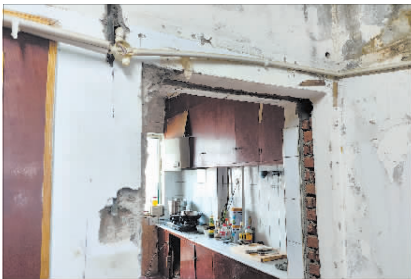
室内墙皮脱落、电器停用。
