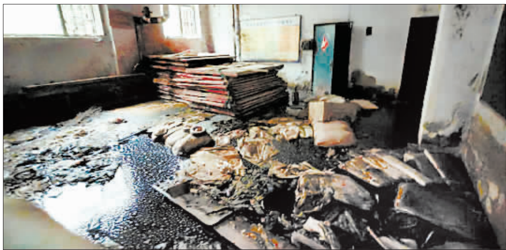
被污水浸泡的地下室。
