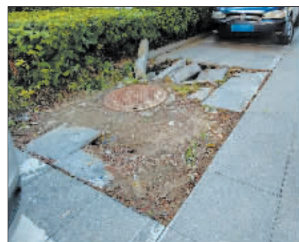
群力第五大道2688号广发银行门前的破损步道板。
