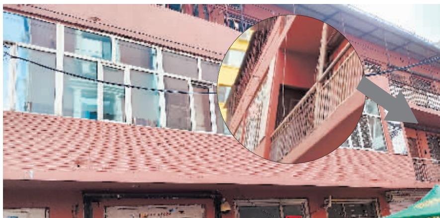
公共走廊被邻居封上了。
