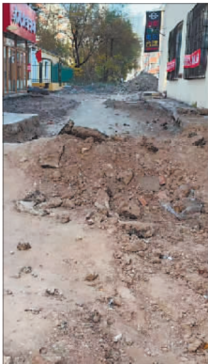
小区路面凹凸不平。
