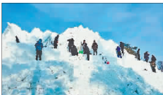
雪博会倾情打造创意雪雕，园区雪雕雕刻工程正在紧锣密鼓地进行中。本报记者 张鸣霄摄
