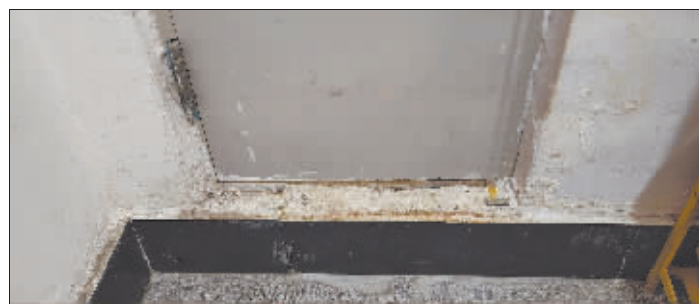
楼道被泡后留下痕迹。
