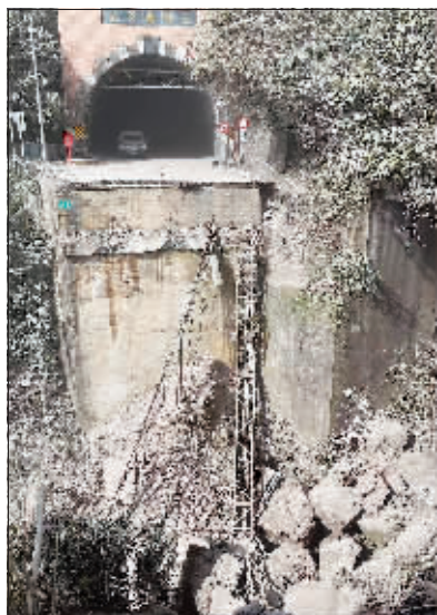
苏花公路大清水隧道外发生塌方。
