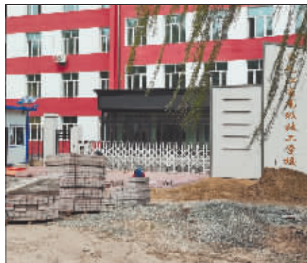
小区内的省技工学校门前堆积建筑垃圾。
