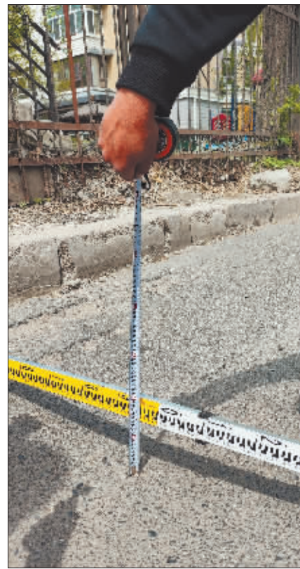
小区内道路多处塌陷下沉。
