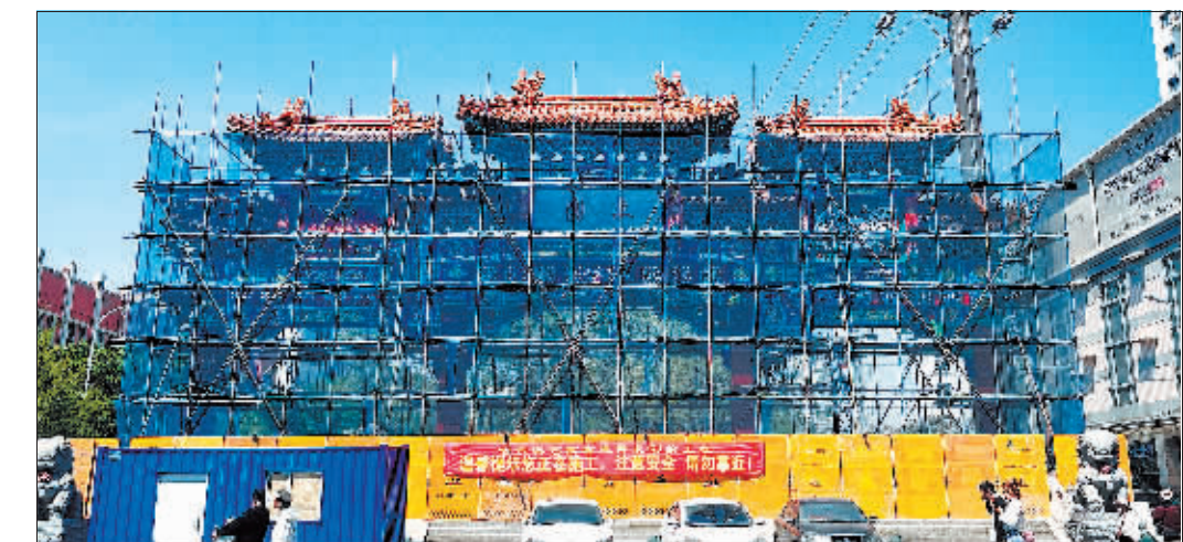
日前,南岗区北宣桥街上,文园牌楼翻新工程正在紧张进行中。文园牌楼建于2003年,是中国传统四柱七楼牌楼,亦称为“步步高”牌楼。此次工程将利用古建修复彩绘技术对牌楼上金龙和玺油漆彩画进行全面翻新,届时这一标志性人文景观将新装亮相。
