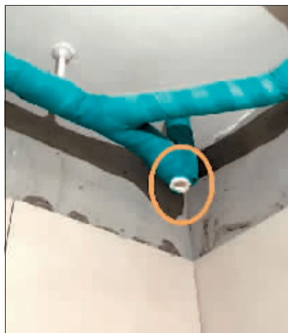
卫生间内渗漏的管线。
