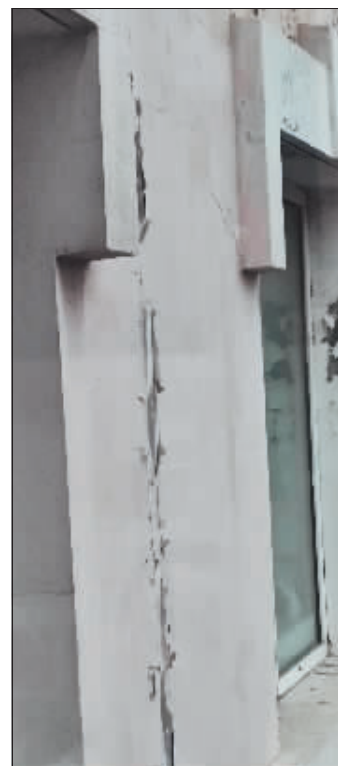
住户外墙也出现裂缝。
