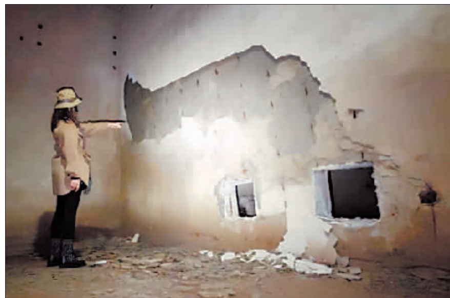
地下室内剥落的墙体。
