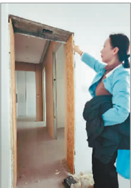
各房间的门均未安装。
